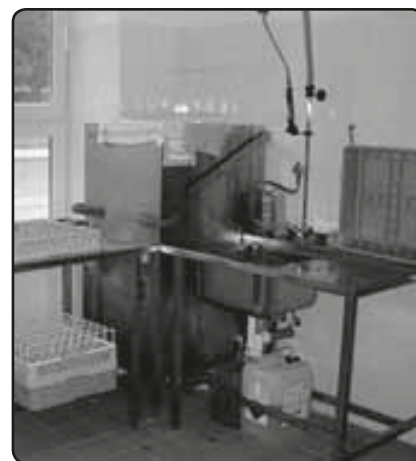
Moderní myčka nádobí ve zrekonstruované školní kuchyni
