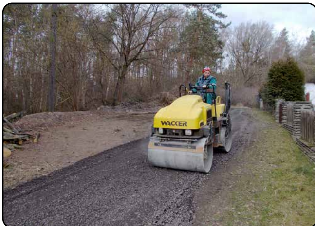
Některé poškozené úseky nezpevněných komunikací byly provizorně vyspraveny
