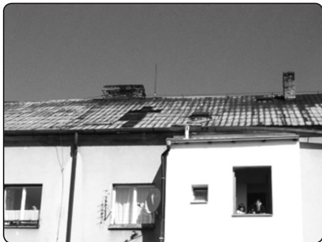
Poškozená střecha domu č.p. 160 v Dlouhé ulici.
