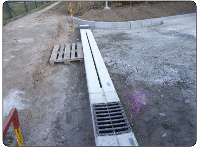
Vpust' na deštovou vodu u zahrádek na severním konci Zahradní ulice
